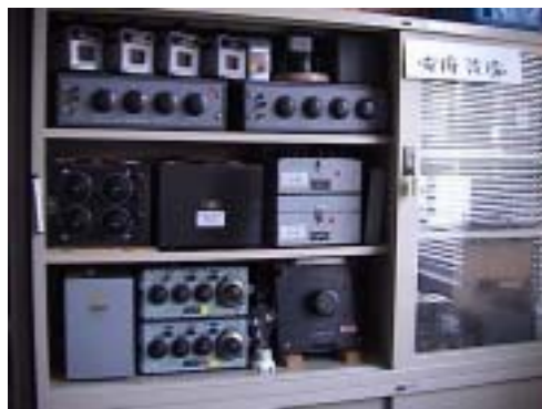
写真4 電気主任技術者認定校用設備保管庫
